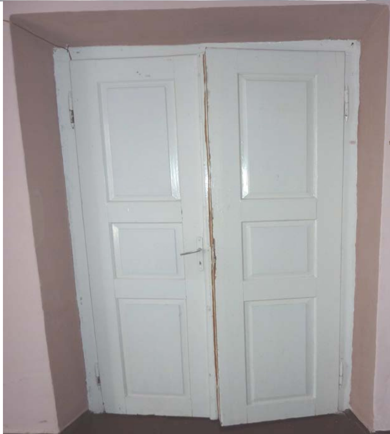
Fot. 11 i 12 Widok okna O1 od wewnątrz oraz drzwi wewnętrznych Dw3
